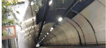
▲問題のトンネルの入り口に歩行者通行禁止の標識が!!でも弱視の僕には、この標識が見えなかった…
